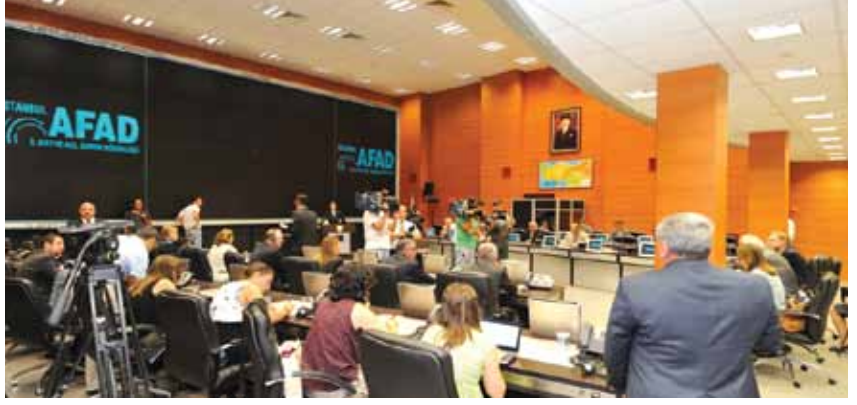
'Operasyon Salonu'na kurulan 45 m 2 alanlı; 67 inçlik ve 32 parça modülden oluşan görüntü duvarı sistemi ile İstanbul Büyükşehir Belediyesi'ne ait yol ve İstanbul Emniyet Müdürlüğü'ne ait MOBESE kamera görüntülerine ulaşılabilir.
