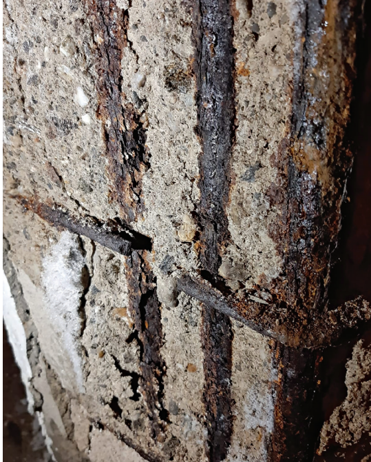
Resim 3. Donatılarda Korozyon Hasarı (Fikret Kuran arşivi)
